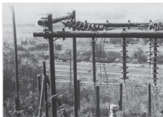
Rys. 12. Fragment stacji prób izolatorów w Wałbrzychu [16, 17]
