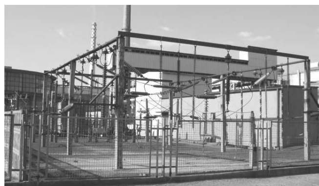
Rys. 9. Terenowa stacja prób izolatorów w Hucie Miedzi Głogów [9]
